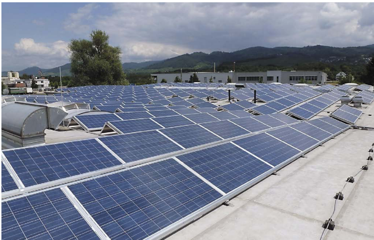
Dachflächen ausreichend für mehrere hundert Kilowatt Anlagenleistung gibt es durchaus: Hier eine 650-Kilowatt-Anlage in Hochstadt, installiert von der Solar-Info-Zentrum SIZ GmbH.
